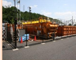
【Effluent treatment facility】
