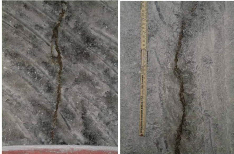
Abb. 13.6 Rissbildung, die in /BAU 91/ als „kryogene Klüfte“ bezeichnet wird, auf der 350 m-Sohle im Kalisalzbergwerk Sigmundshall (Salzstock Bokeloh) (Fotos aus /HAM 12/)
