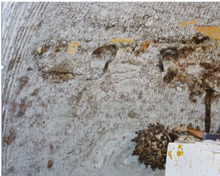
Abb. 13.3 Blick auf eine ehemalige, konvergierte Strecke im Grubengebäude der Schachtanlage Asse II westlich von Schacht 4 auf der 700 m-Sohle /ASS 12/
